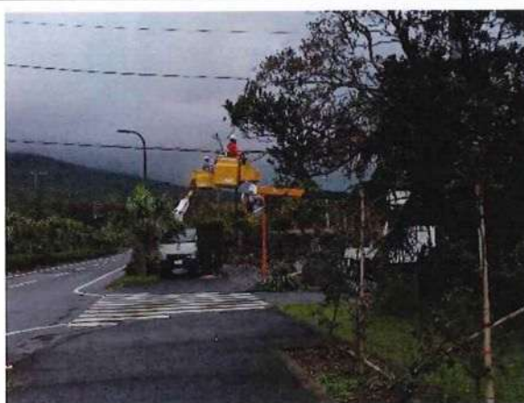
AGL W4 付近にて通信線切れあり、監視装置にて AGL 伝送異常の警報発報あり。NTT 復旧作業時に現地立会い（同様他 2 件）。
