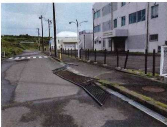
航空局庁舎の駐車場フェンスが倒壊、空港内道路へ飛散しており、一時撤去実施。
