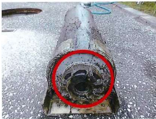
経年劣化によりチャッキ弁破損
