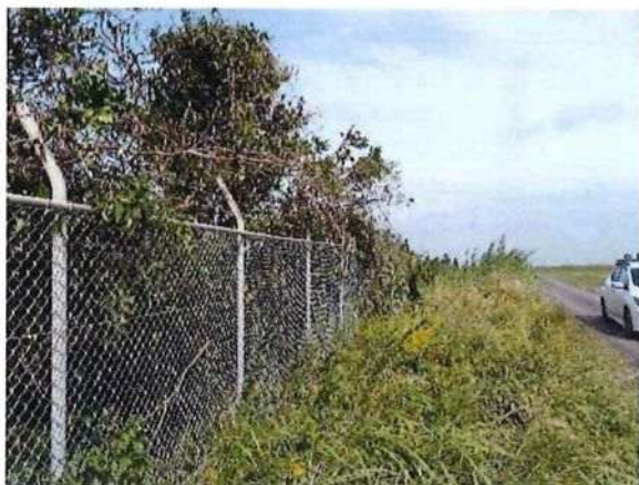
立入禁止柵近辺での倒木等により、有刺鉄線の切断が多数発生。
