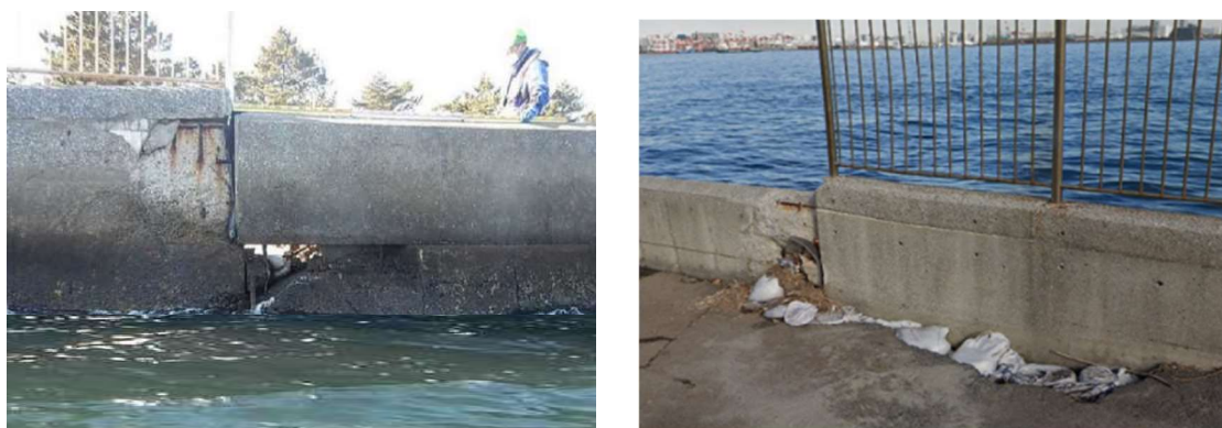
図 2-6 コンクリート護岸の鉄筋腐食による損壊 (鉄筋腐食によりコンクリートが剥落)
