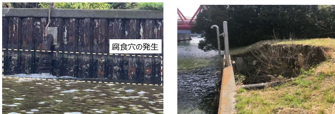
図 2-5 鋼矢板護岸の腐食による損壊 (干満帯付近に腐食穴が発生し土砂が流出)
