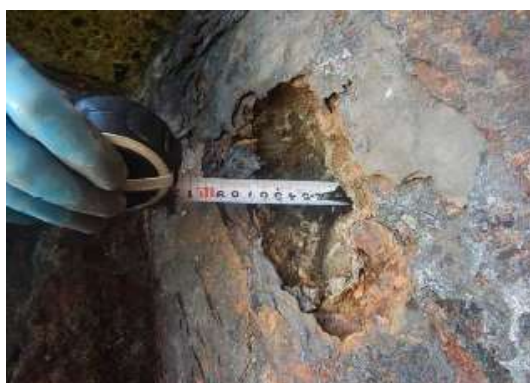
図 2-11 鋼矢板護岸の腐食状況測定（海上部）
