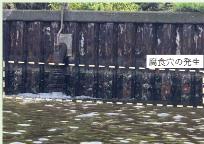
鋼矢板護岸の劣化・損傷 (干満帯付近に腐食穴)
