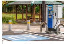
EV充電スタンド
