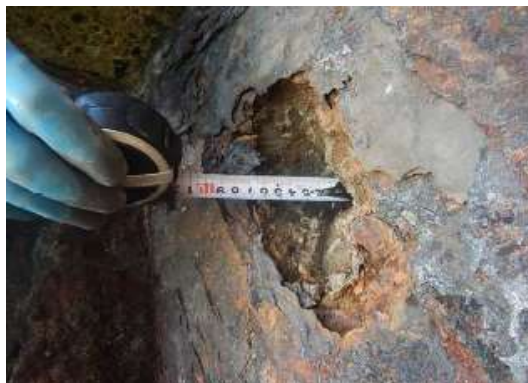
図 2-11 鋼矢板護岸の腐食状況測定（海上部）
