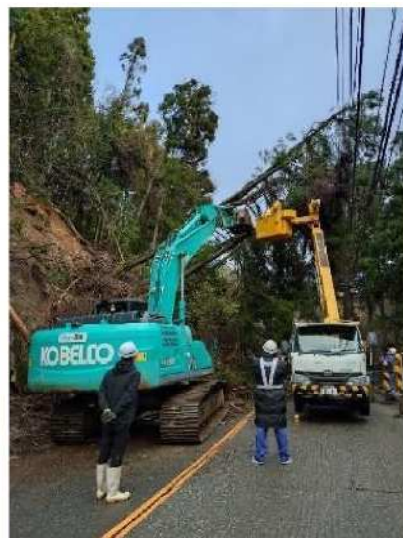
石川県穴水町 県道303号
