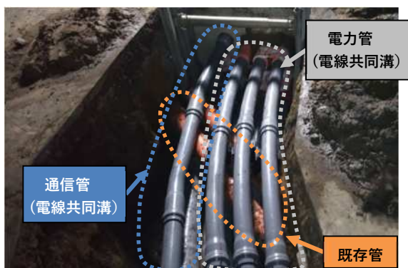
図 3-2 地下埋設物の輻輳状況
