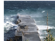
写真左：ケーソン移動後 写真右：飛散したパラペット
