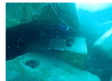
写真左：ブロック飛散状況 写真右：マウンド洗掘状況
