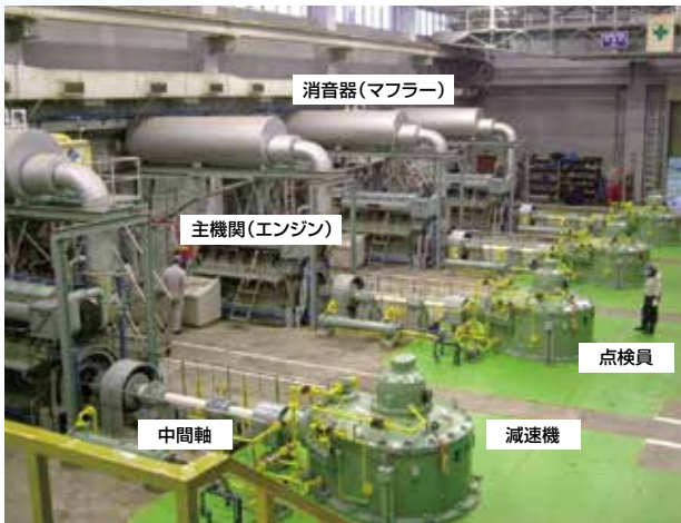
【辰巳排水機場エンジン室】
