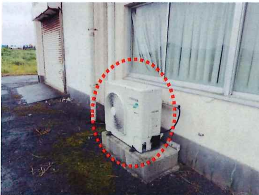
故障したエアコン室外機
