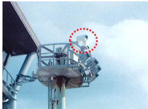
エプロン照明塔柱に設置
