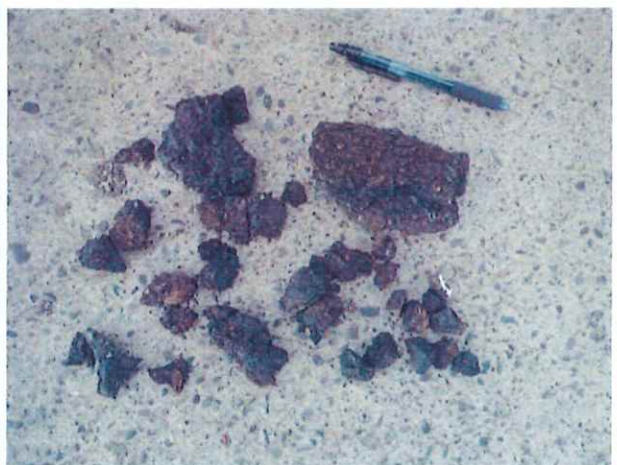
剥離したアスファルト
