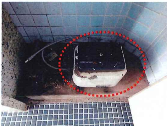
故障した浄化槽ダイヤフラム。
