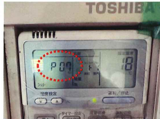
エラー表示から室外機の基板故障が原因と判断。
