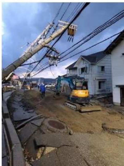
石川県輪島市 国道249号
