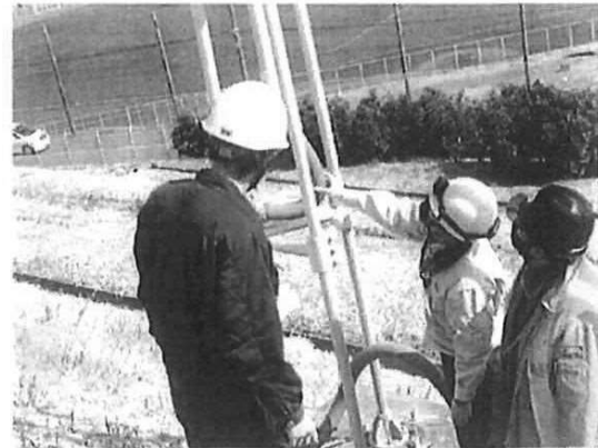
支柱は点検等のため可倒式となっているが、繰り返し動作により、可とう電線管に負荷が掛かっているように見受けられる。
