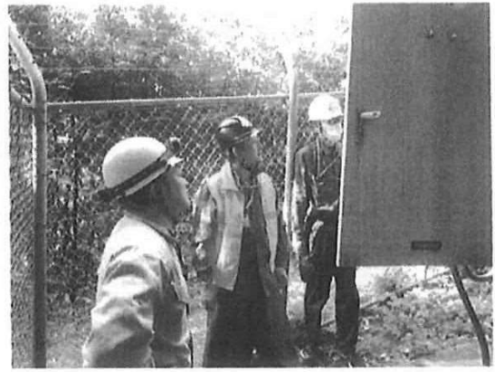
盤内部品に一部劣化が見られたが、機能に影響しないものであったため、対応不要と判断した。
