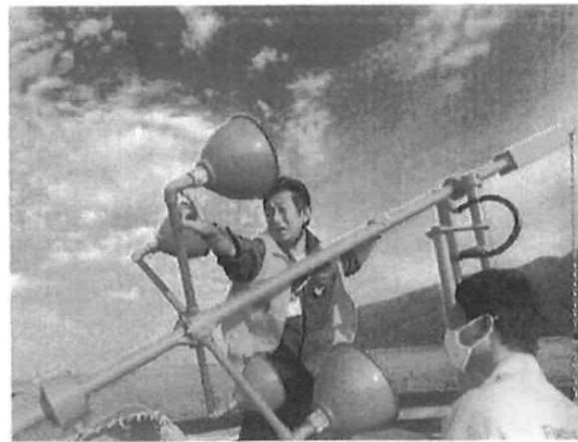
電球の玉切れが頻繁に発生し、また絶縁抵抗が大きく低下する症状が見られるようになっていた（直近の測定で絶縁抵抗 1MΩ未滿）。
