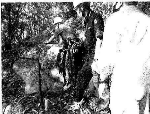
ケーブルが垂れ下がっていた箇所をバインド線で岩の方へ吊り上げることで、自重による負荷を軽減。
