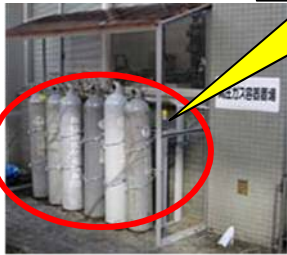
ボンベ保管状況
