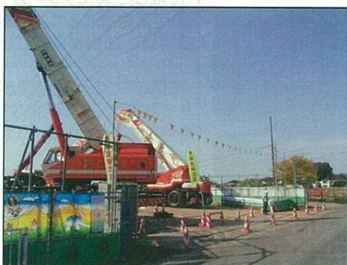
高さ制限表示の設置
