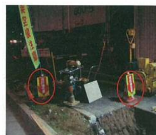
地下埋設物の目印表示(看板)
