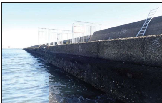
外郭施設（防波堤）
