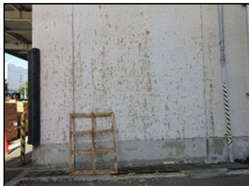
上屋の損傷状況（荷さばき施設）
