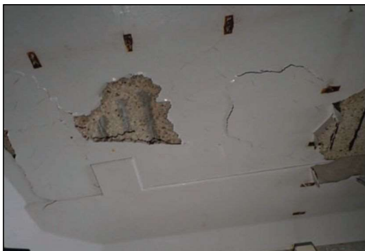
栈橋上部工の損傷状況（係留施設）
