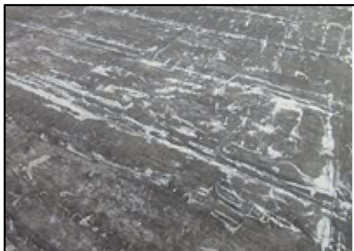
上屋の損傷状況（荷さばき施設）
