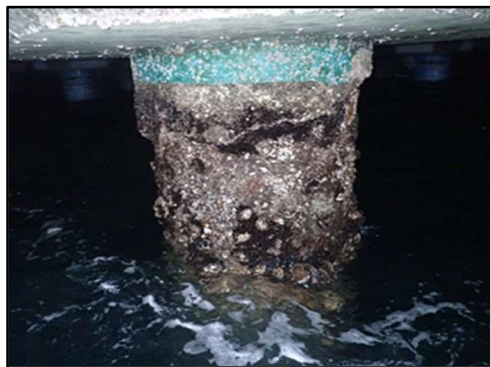
栈橋下部工の損傷状況（係留施設）
