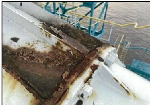
荷役機械の損傷状況（荷さばき施設）
