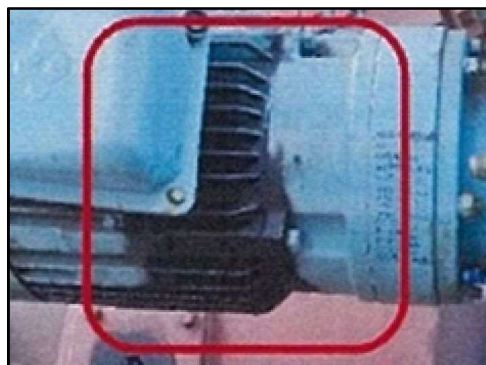
ホーディングブリッジの劣化状況（旅客乗降施設）
