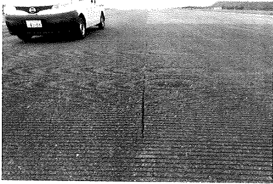
長さ2m程度のひび割れ、路面隆起あり。
