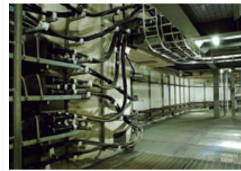
電気・通信・情報通信ケーブル
