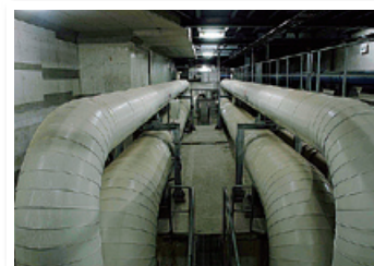
地域冷暖房用熱供給管
