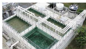
水処理システム
